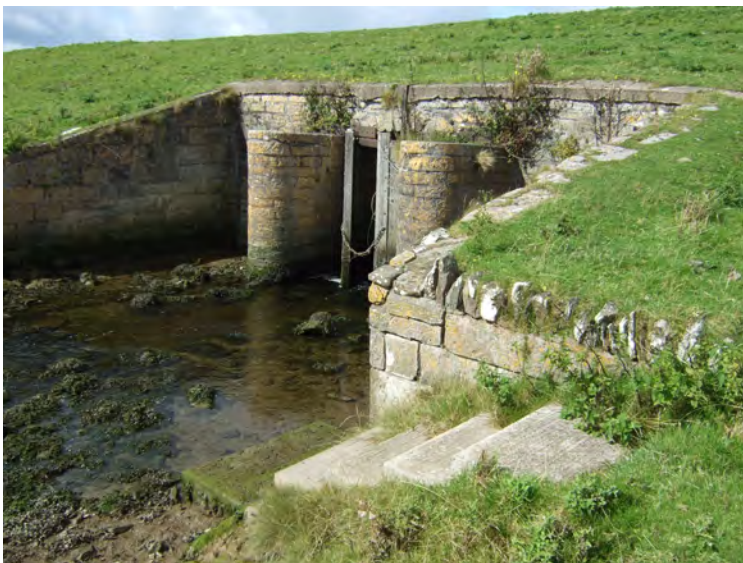
オランダの技術を用いた 水門。潮の干満により自動 的に開閉する。
